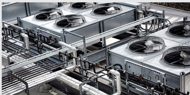
Системы вентиляции и охлаждения
