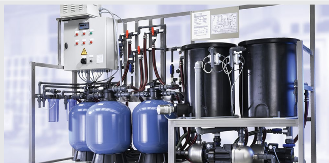
Системы водоснабжения и водоподготовки
