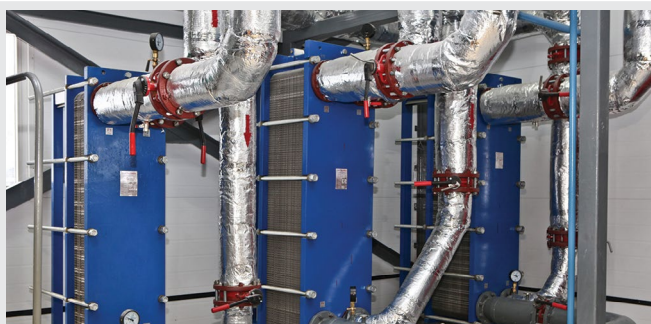
Измерение температуры теплоносителя в теплообменнике
