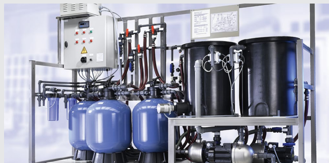
Системы водоснабжения и водоподготовки
